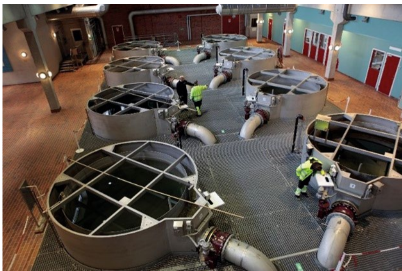
Blødgøringsreaktorer ved Vombverket
