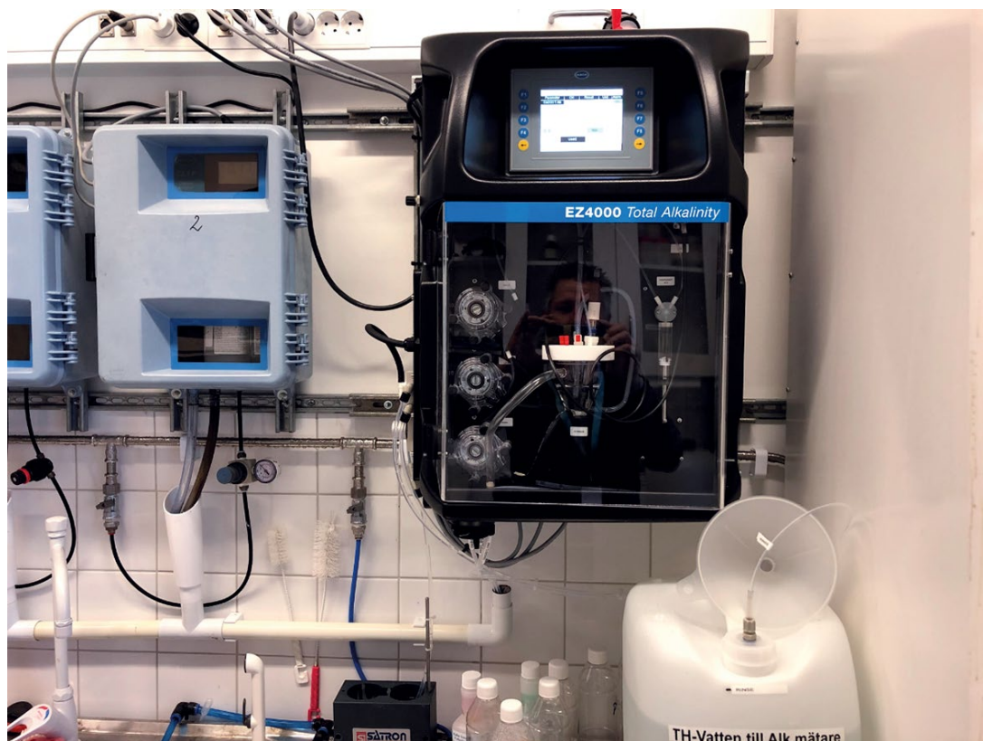
Installation af EZ4000 analysator til måling af total alkalinitet ved Vombverket
